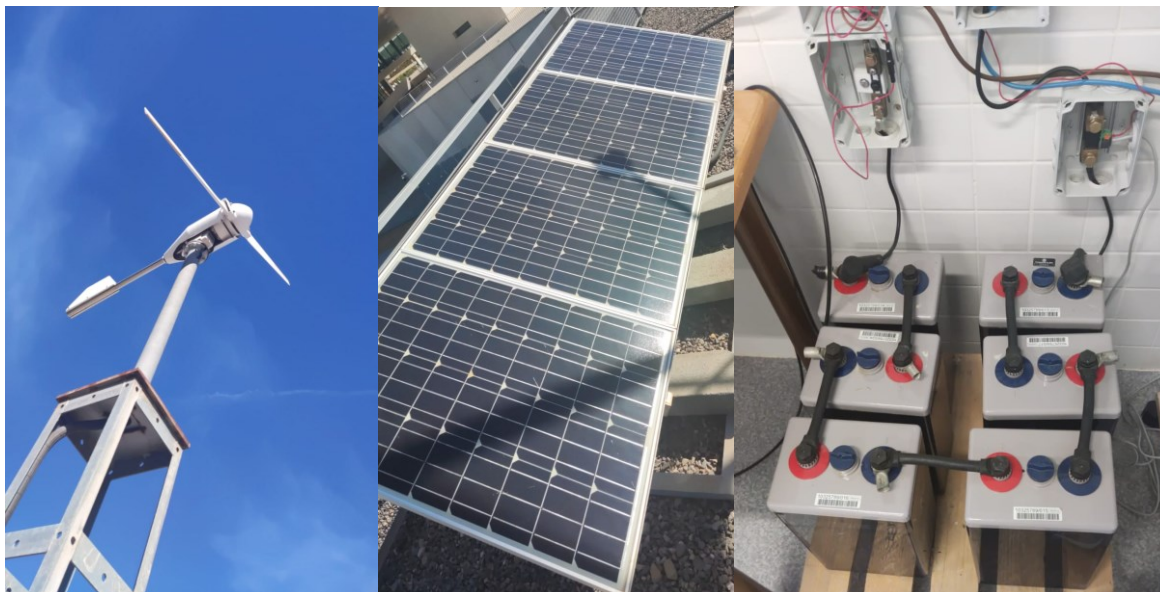
Figura 1. Equipos instalados en la microrred: aerogenerador ( izda ), paneles solares fotovoltaicos ( centro ) y banco de baterías de Pb-ácido ( dcha ).
